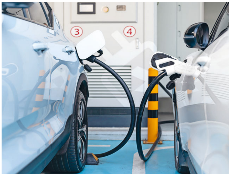
Als kantonsspezifische Fördermassnahme unterstützt Luzern den Einbau von Basisinfrastruktur für Elektromobilität in Mehrfamilienhäusern. (Bilder: zvg)
